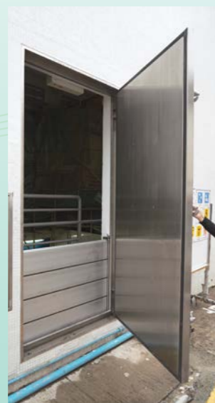
水密門 Portas Estanques Watertight Door
